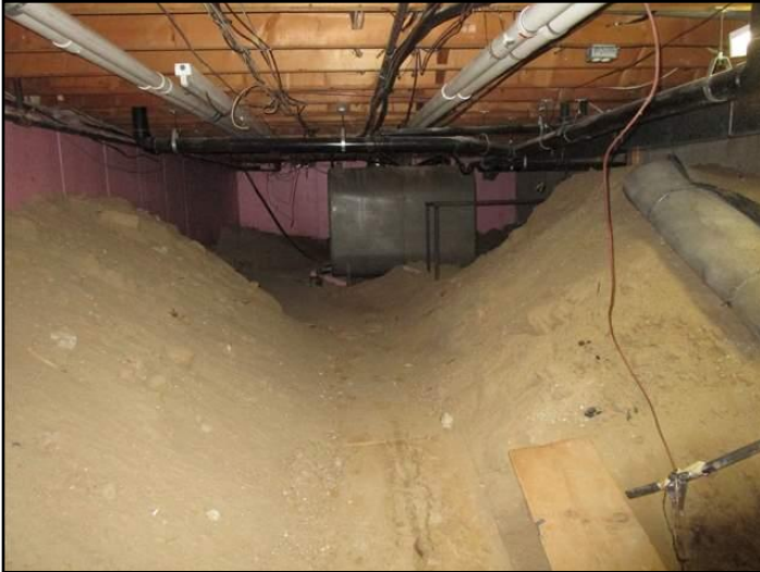
No vapor barrier
