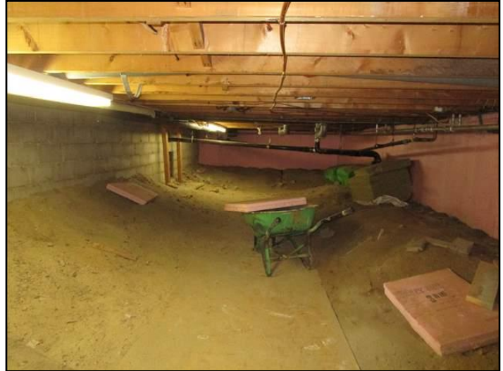
No vapor barrier
